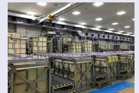
半導体用スパッタリングターゲットの設備、電解槽(当社磯原工場)
