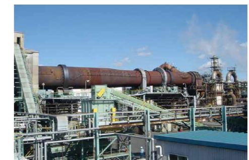
JX金属苫小牧ケミカル(株)のロータリーキルン式焼却炉
